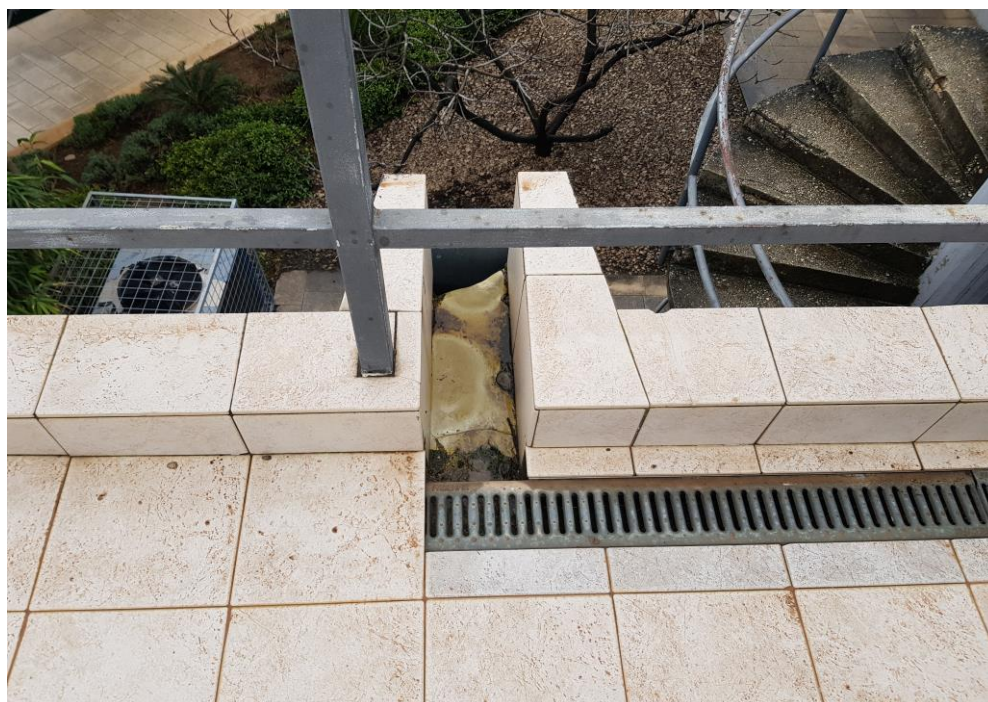
Fotografija br.4 : izvod oborinske vode kroz ogradni parapetni zid do odvodne vertikale (vidljiva dijelom oštećena hidroizolacijska membrana)
