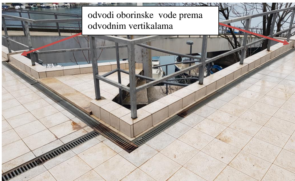
Fotografija br.3: odvod oborinskih voda sustavom izvedenih kanalicu u cem.estrihu s pokrovom od pocinčanih rešetki do izvoda u ogradnom parapetnom zidu terase i odvodnih vertikalama (vidljivo propadanje pocinčanih rešetki)
