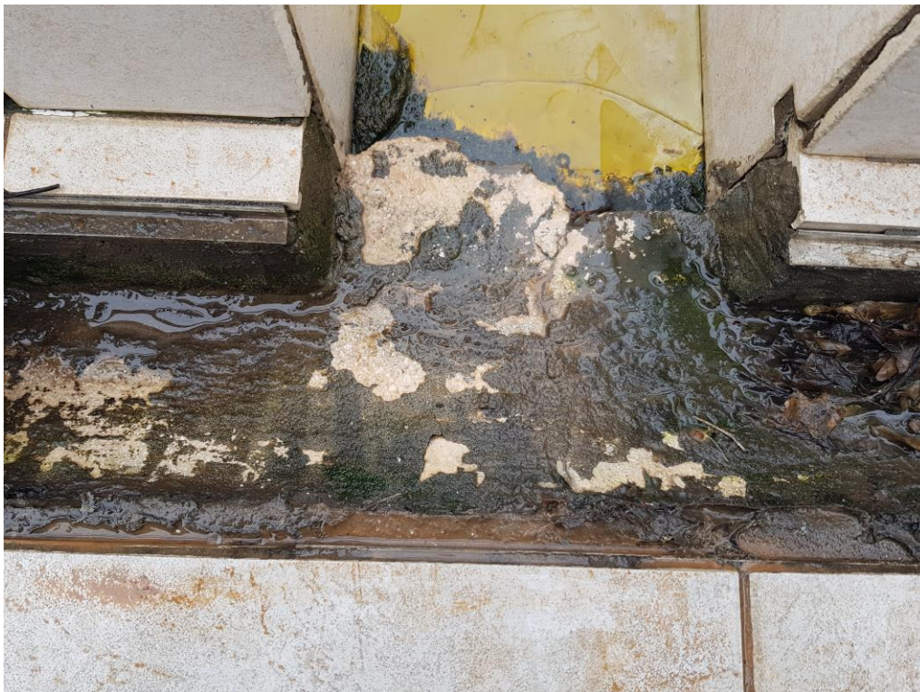
Fotografija br.5 : neuredan detalj izvedenog cem.estriha i hidroizolacijske membrane na izvodu odvodnje kroz ogradni parapetni zid terase
