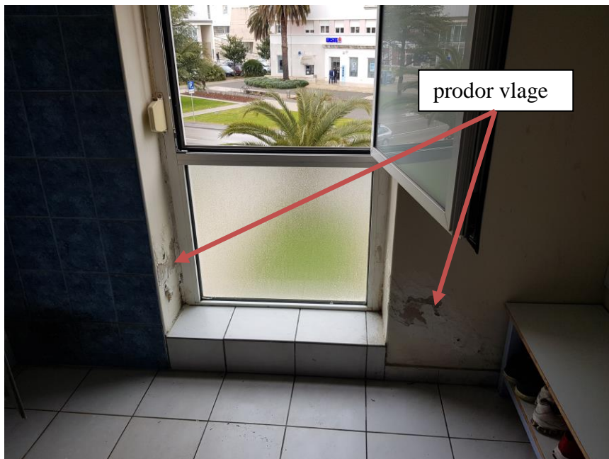
Fotografija br.20 : vidljivo vlaženja i oštećenja zidova uz rubove stolarije
