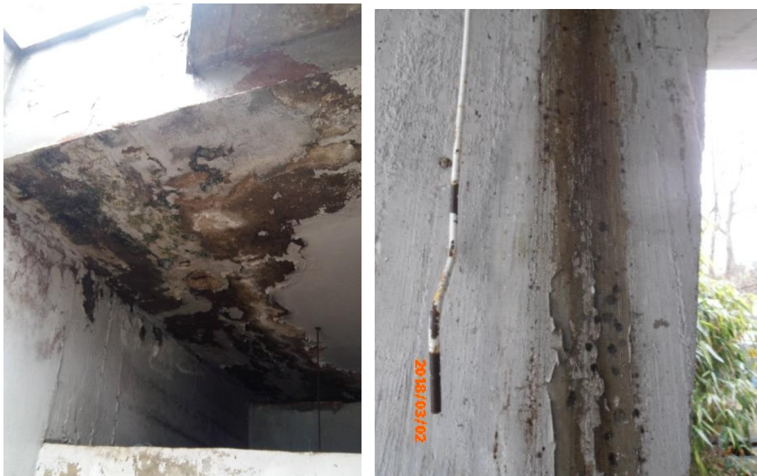
Fotografija br.15 i 16: vlažni i oštećeni stropovi i zidovi ispod prohodne terase
