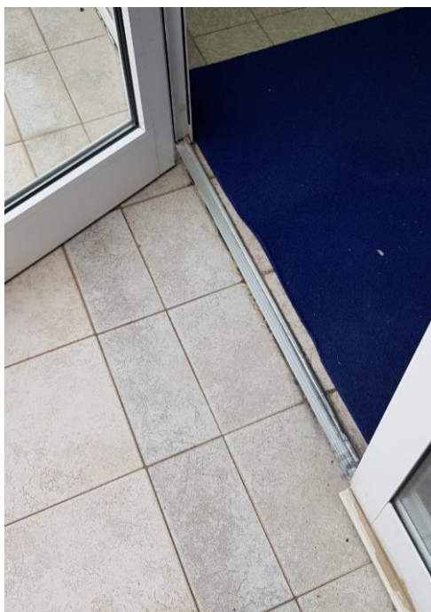
Fotografija br.10 : spoj ulaznog praga i unutarnjeg poda stolarije u istoj razini s podom terase (omogućeno podlijevanje oborinskih voda ispod vrata)
