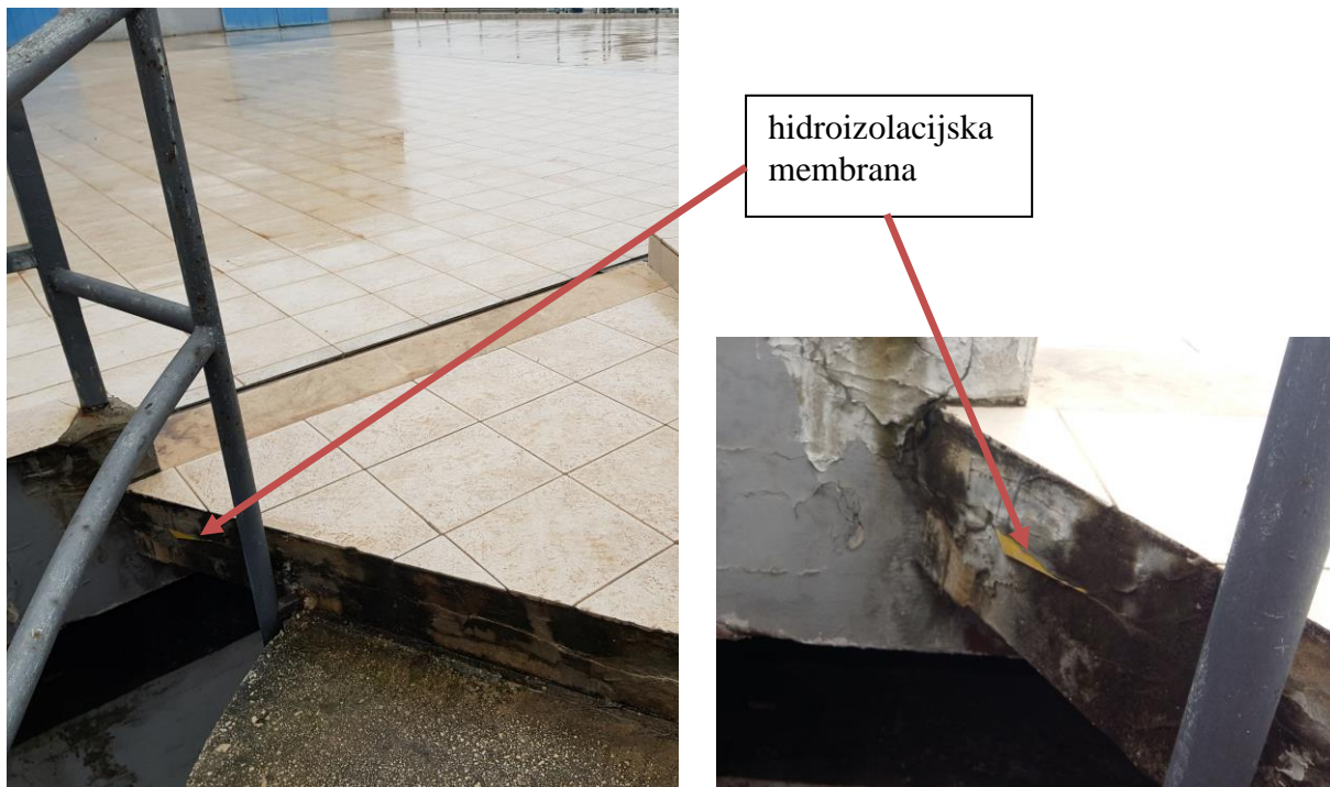
Fotografija br.8 i 9 : vidljivi prodori hidroizolacijske membrane izvan konstrukcije ( moguće podlijevanje oborinskih voda ispod membrane odnosno prodor u konstrukciju ispod iste )
