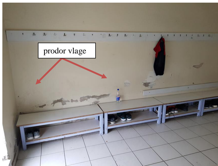
Fotografija br.21 : vidljivo vlaženje i oštećenje zidova na vanjskom nosivom zidu
